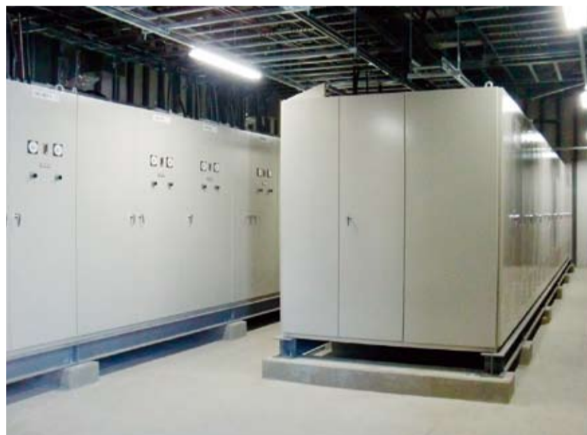
◀ 高圧受変電設備 設置状況
