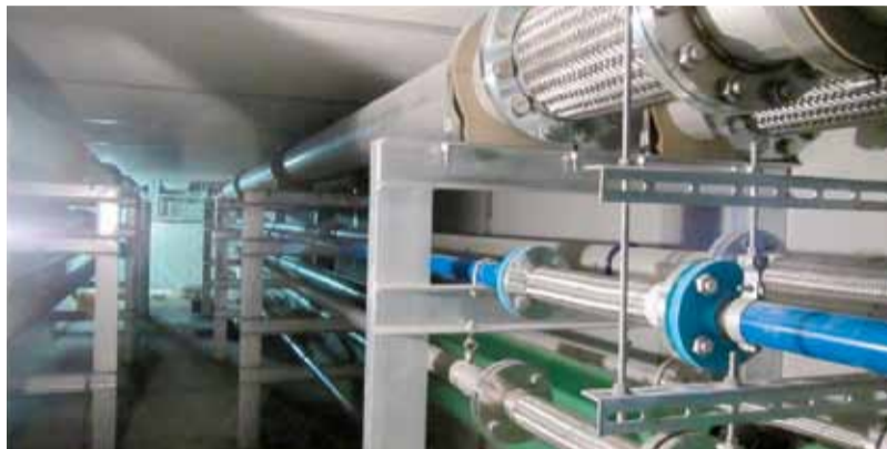
◀共同溝（配管主管） 病院棟と機械棟を地下で結ぶ各種配管
